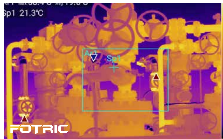
地热管道阀门检测
